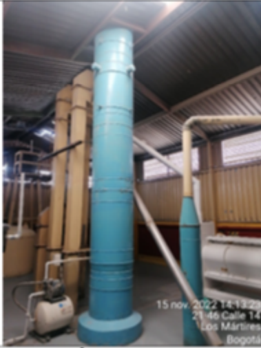
FOTOGRAFÍA No. 7. Ducto de descarga (deschinadora y descargue de trigo)
