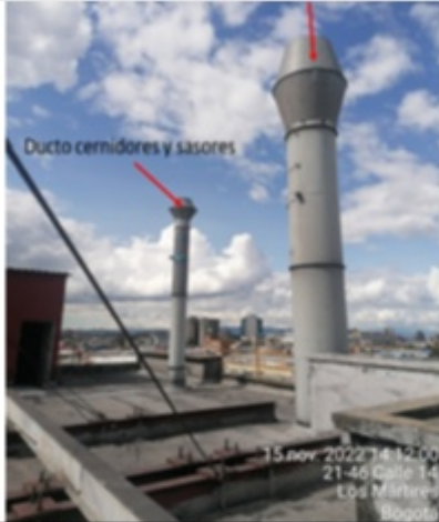
FOTOGRAFÍA No. 13. Vista general superior del horno Hoffman
