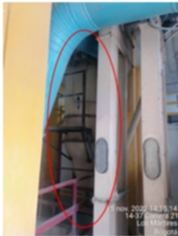
FOTOGRAFÍA No. 15. Cámara de sedimentación.
